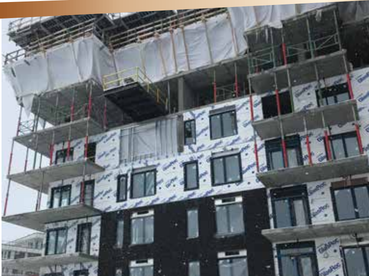
Exemple de productivité du système D-Max. Les parements sont installés du rez-de-chaussé au 3ème étage, on isole de l'intérieur au niveau 4 et 5 et on coule la structure au niveau 6 et 7.
